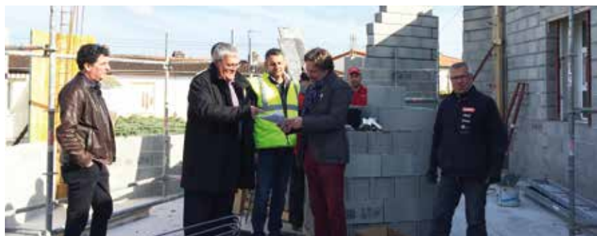
Reunion de chantier en présence d'Yves Lauvergeat, maire-adjoint à la culture et d'Olivier Audebert, architecte
